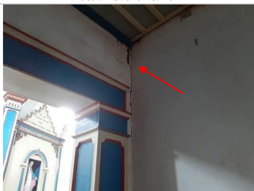
Foto 22. Vista trinca interna Autor: Fernanda C.A.von Sperling Data: Fevereiro/2022
