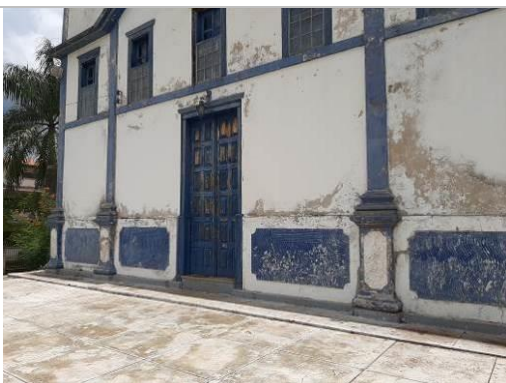
Foto 25. Manchas e descascamentos na base. Autor: Fernanda C.A.von Sperling Data: Fevereiro/2022
