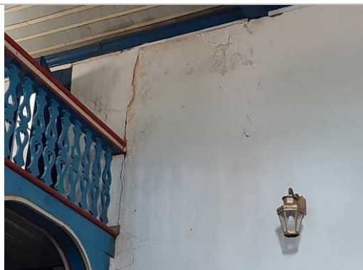
Foto 7. Trinca no coro Autor: Fernanda C.A.von Sperling Data: Fevereiro/2022
