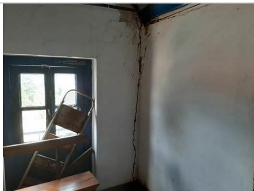
Foto 8. Trinca severa no coro Autor: Fernanda C.A.von Sperling Data: Fevereiro/2022
