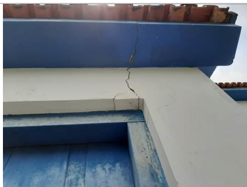
Foto 18. Trinca no beiral. Autor: Fernanda C.A.von Sperling Data: Fevereiro/2022
