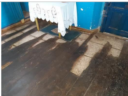
Foto 43. Piso em madeira com perdas significativas.
