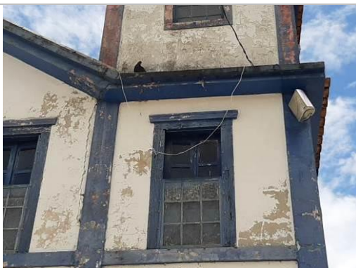
Foto 59. Fiação exposta na fachada.
