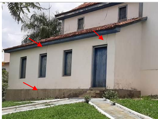
Foto 19. Vistas de trincas externas na alvenaria Autor: Fernanda C.A.von Sperling Data: Fevereiro/2022
