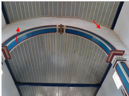
Foto 5. Trincas no arco interno Autor: Fernanda C.A.von Sperling Data: Fevereiro/2022
