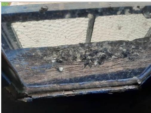
Foto 37. Excrementos de pombos na janela. Autor: Fernanda C.A.von Sperling Data: Fevereiro/2022
