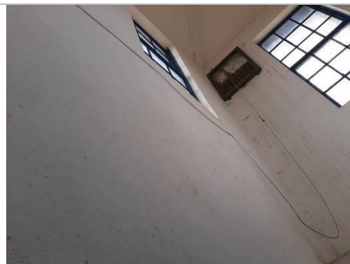
Foto 60. Fiação exposta na torre.
