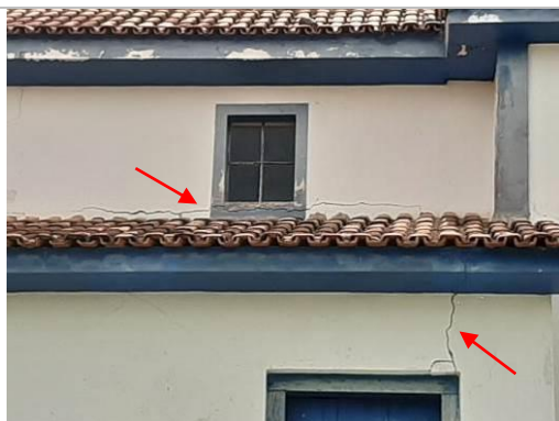
Foto 20. Vistas de trincas externas na alvenaria. Autor: Fernanda C.A.von Sperling Data: Fevereiro/2022
