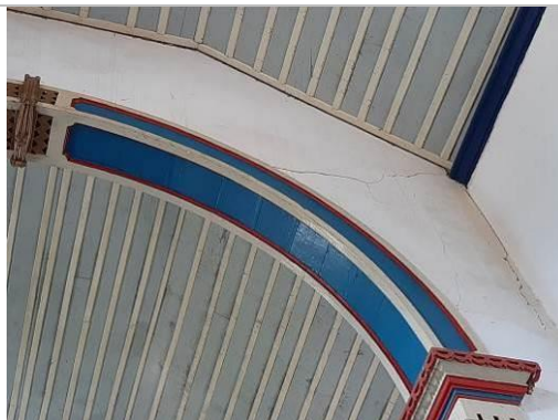
Foto 6. Detalhes da trinca Autor: Fernanda C.A.von Sperling Data: Fevereiro/2022
